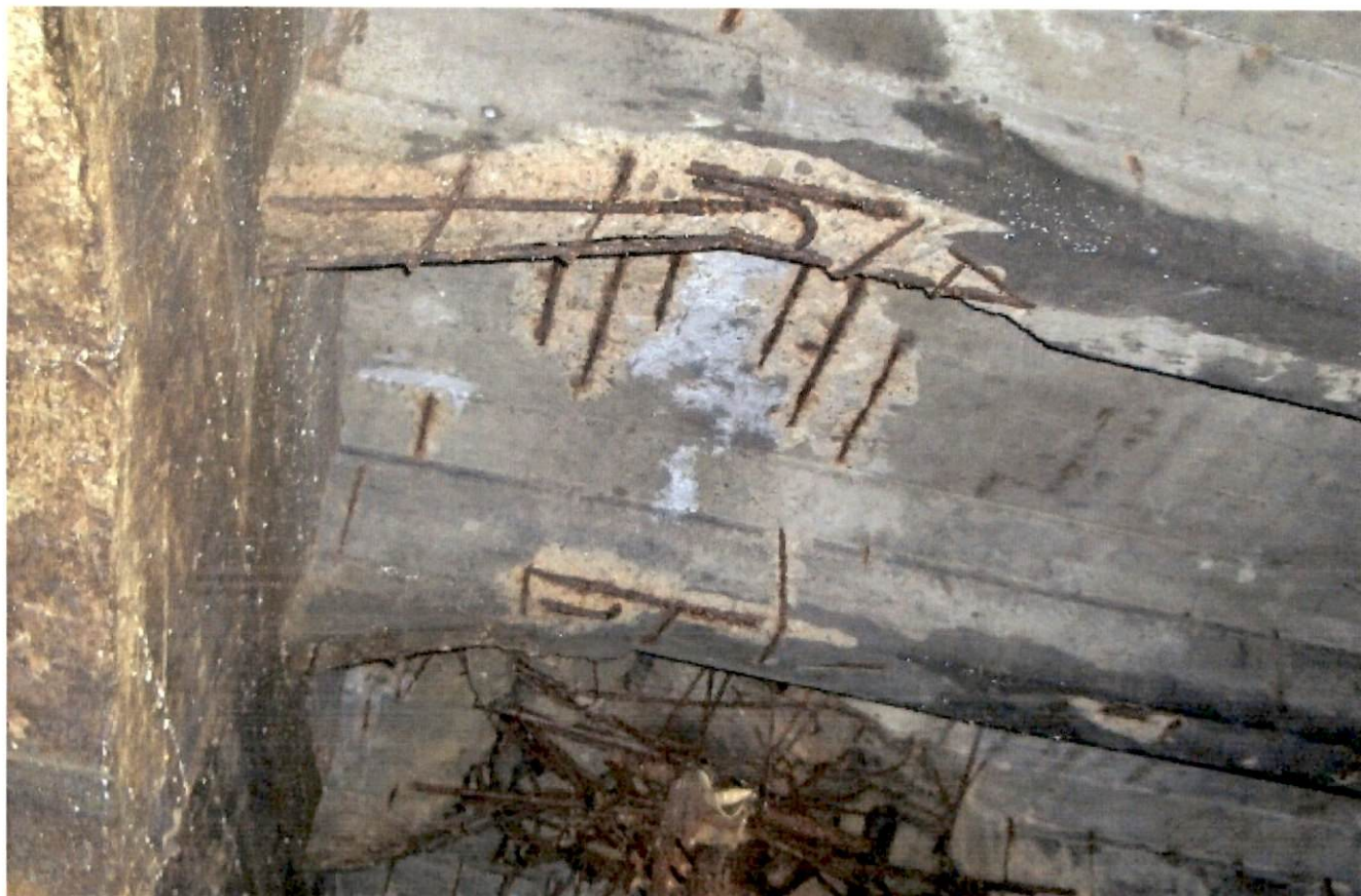
Fotografia 12 – Vedere intrados planseu (armatura fara strat de acoperire, beton exfoliat, armatura corodata, structura perforata, micșorarea secțiunii betonului)
