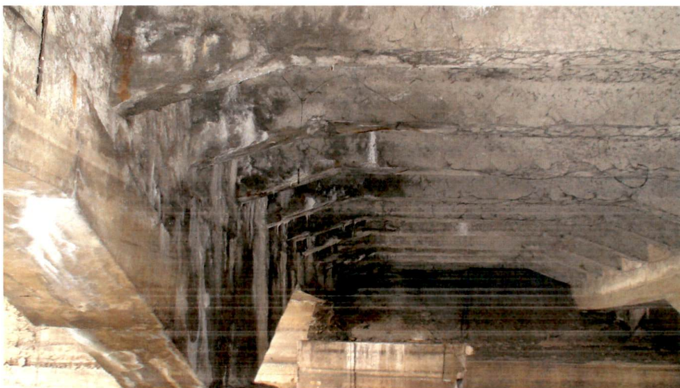
Fotografia 8 – Vedere intrados planseu zona amonte (infiltratii, eflorescente, stalactite, pete de culoare neagra)
