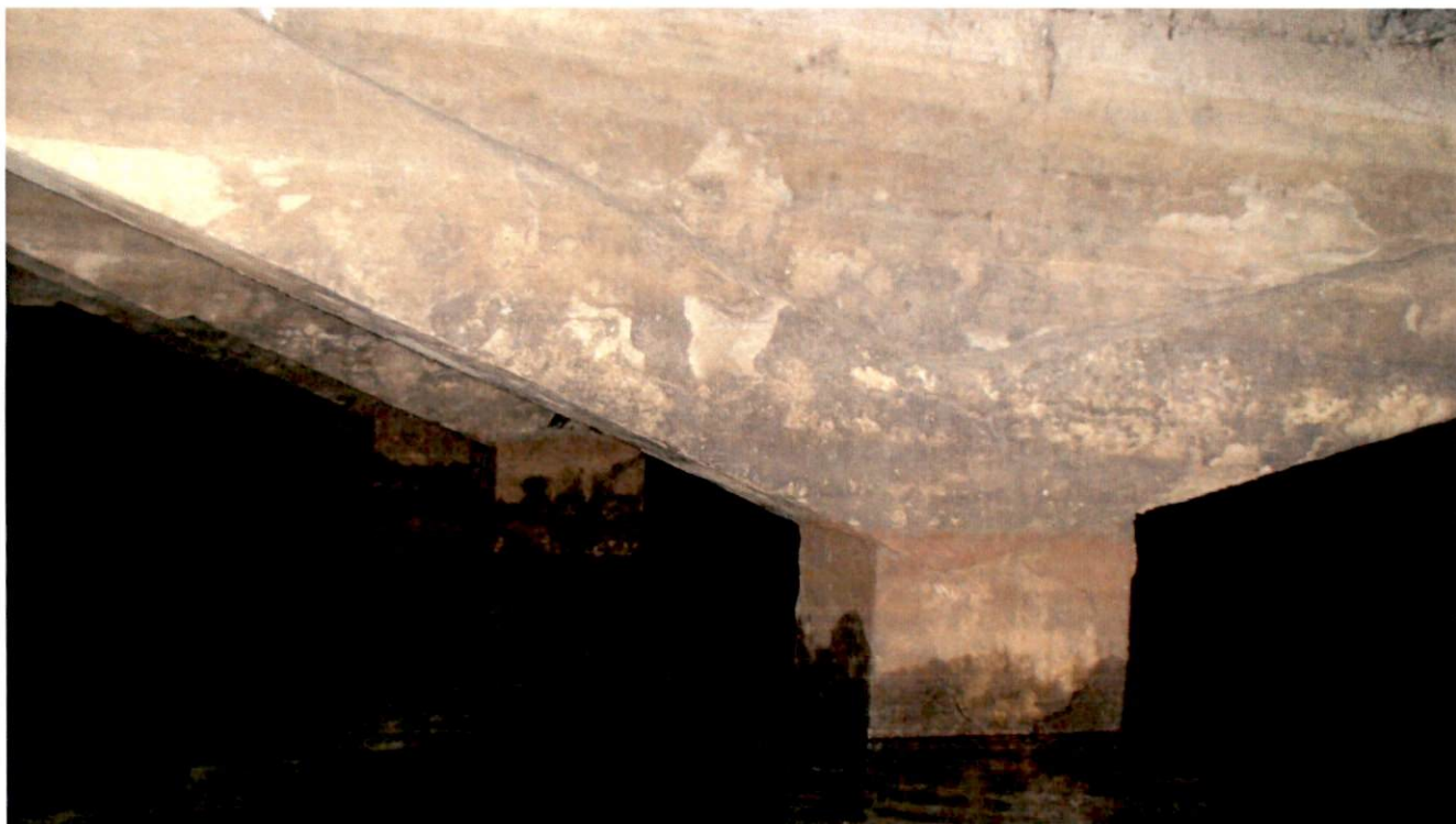
Fotografia 14 – Vedere partea superioara stalp central cadru si rigla
