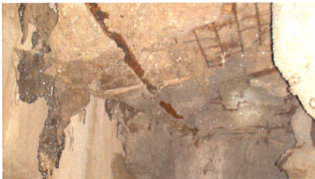
Fotografia 5 – Colaj de imagini cu aspectul planseului (ar,atura fara strat de acoperire, beton exfoliat, armatura corodata, structura perforata)
