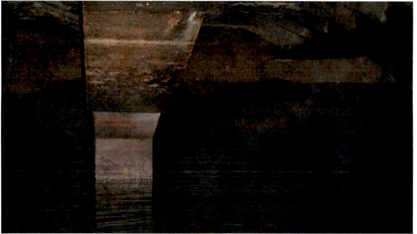
Fotografia 16 – Vedere intrados rigla cadru (infiltratii, efluorescente)
