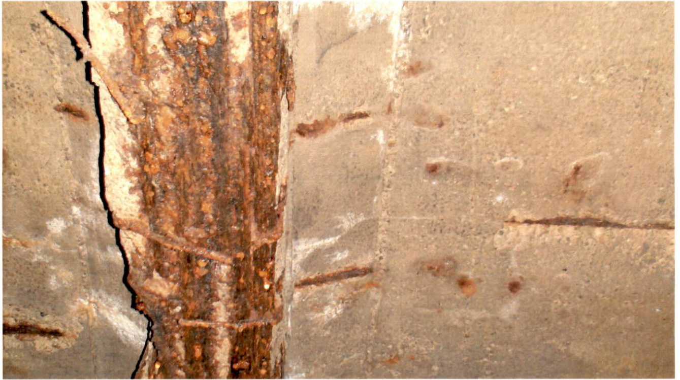
Fotografia 3 – Armatura fara strat de acoperire si corodata la nivelul nervurilor planseului
