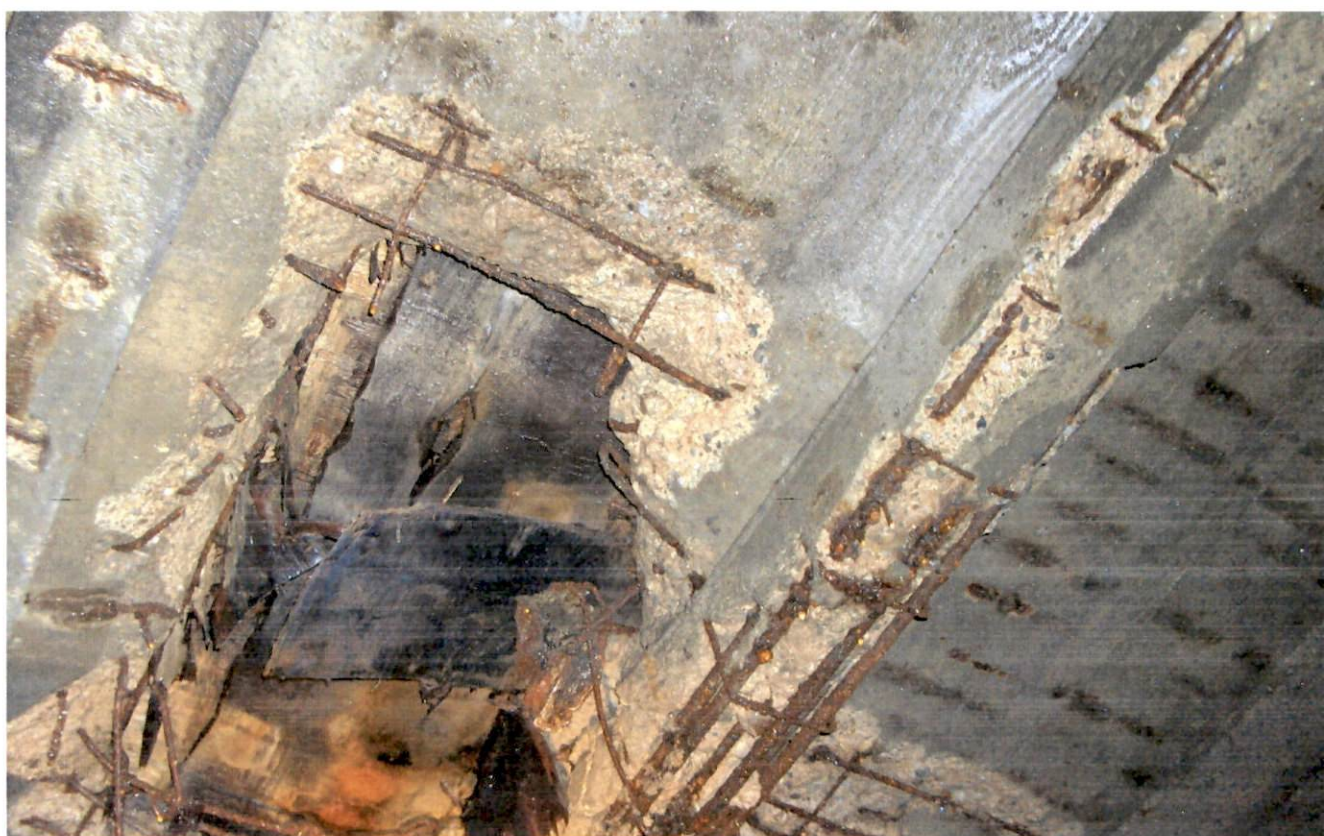
Fotografia 10 –Planseu perforat astupat provizoriu cu placaj din lemn
