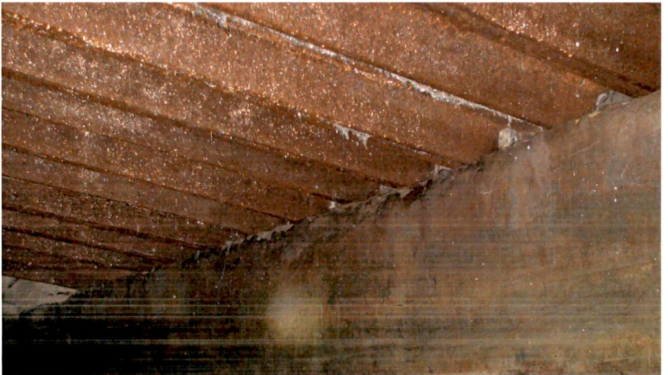
Fotografia 11 –Planseu distrus si reconstruit utilizand un cofraj din palplanse metalice puternic corodate
