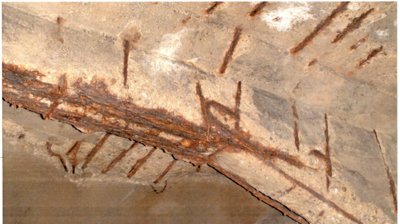
Fotografia 4 – Armatura fara strat de acoperire si corodata la nivelul nervurilor planseului
