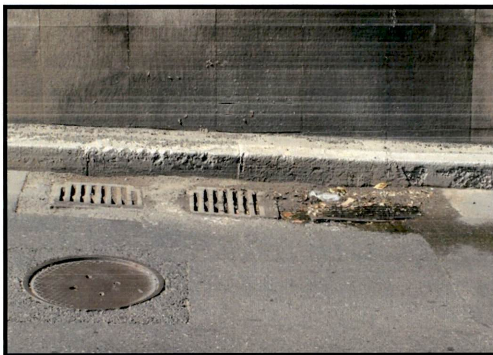
Foto 15 - Amplasarea incorectă a gurilor de scurgere
