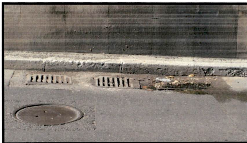
Foto 22 - Guri de scurgere colmatate
