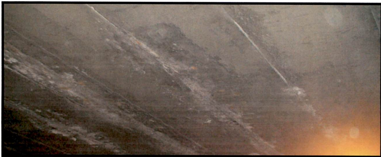
Foto 7 - Beton degradat prin carbonatare, apariția de stalactite și draperii
