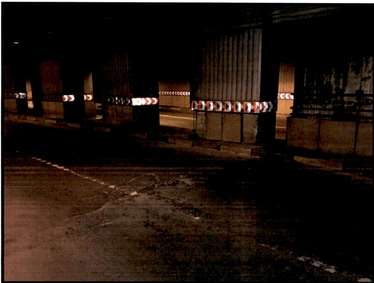
Foto 27 – Zone in care placajul de granit si aluminiu este desprins de pe suportii metalici
