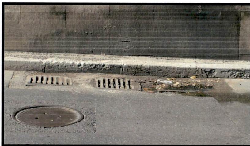
Foto 22 - Guri de scurgere colmatate
