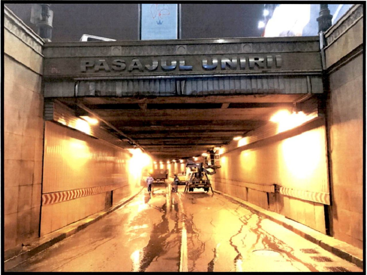
Foto 29 – Degradarea placajului de aluminiu de la portalului de pe rampa I.B. Bratianu
