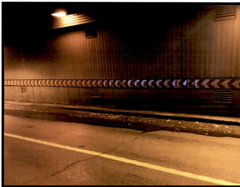
Foto 20 - Degradarea rostului. Infiltrații în zona rostului
