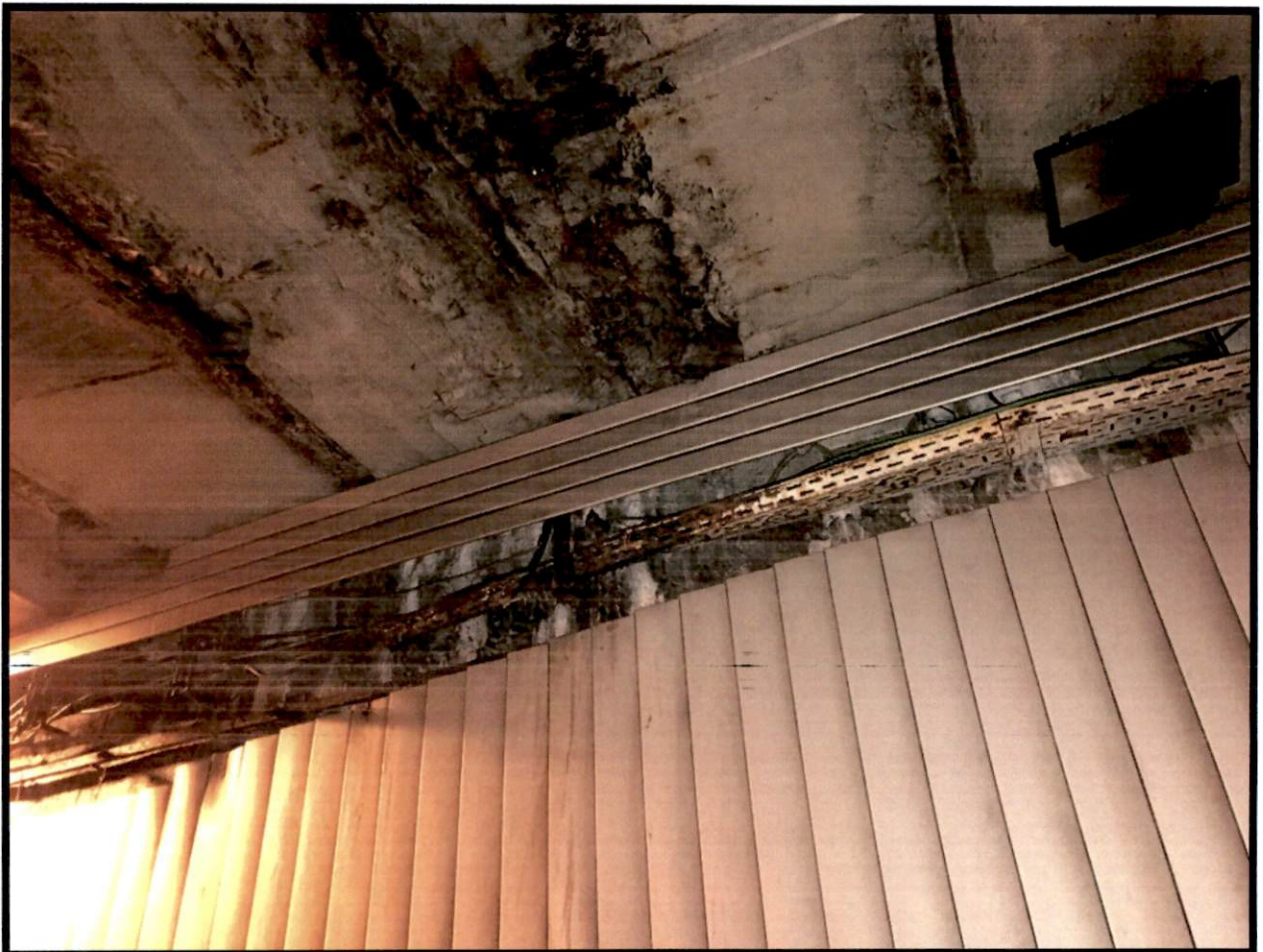
Foto 10 - Solidarizări necorespunzătoare între elementele prefabricate (infiltrații, fisuri, rosturi matate necorespunzător)
