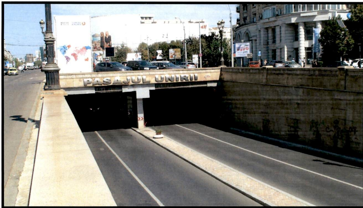
Foto 30 – Degradarea placajului de aluminiu de la portalului de pe rampa I.B. Bratianu
