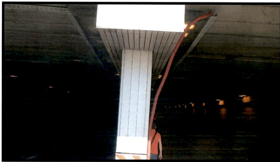
Foto 24 – Vedere sistem de iluminat interior pasaj
