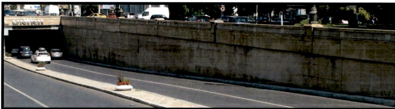
Foto. 14 – Infiltratii pe rampa D. Cantemir
