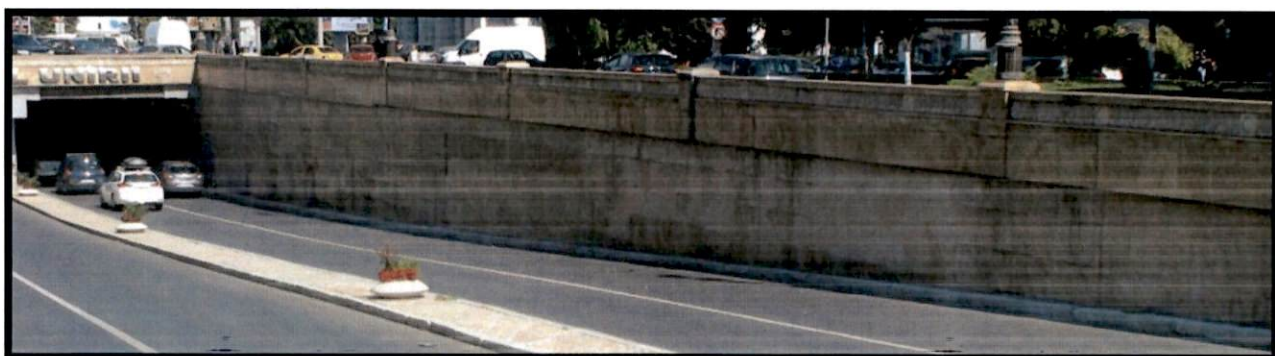
Foto. 14 – Infiltratii pe rampa D. Cantemir
