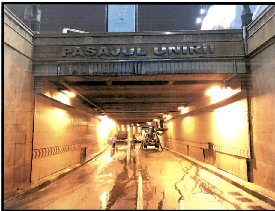
Foto 29 – Degradarea placajului de aluminiu de la portalului de pe rampa I.B. Bratianu
