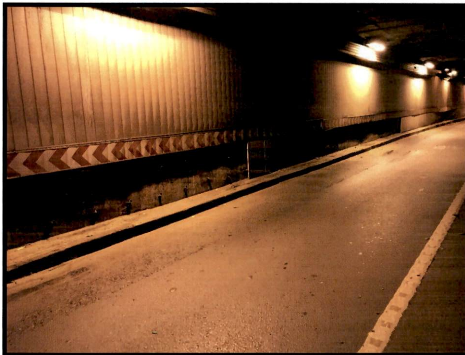
Foto 26 – Zone in care placajul de granit este desprins de pe suportii metalici
