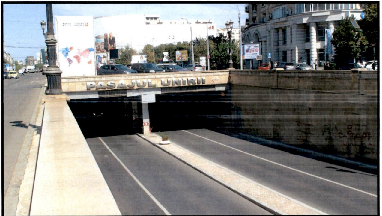
Foto 30 – Degradarea placajului de aluminiu de la portalului de pe rampa I.B. Bratianu
